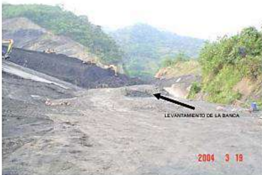
Fotografía 3. Se observa el alzamiento notable de la banca en el mismo sitio de la fotografía anterior, doce días después.
