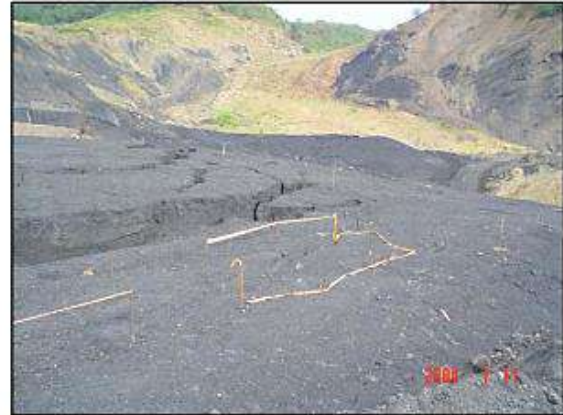
Fotografía 4. Se observa el alzamiento notable de la banca en el mismo sitio de la fotografía anterior, doce días después.
